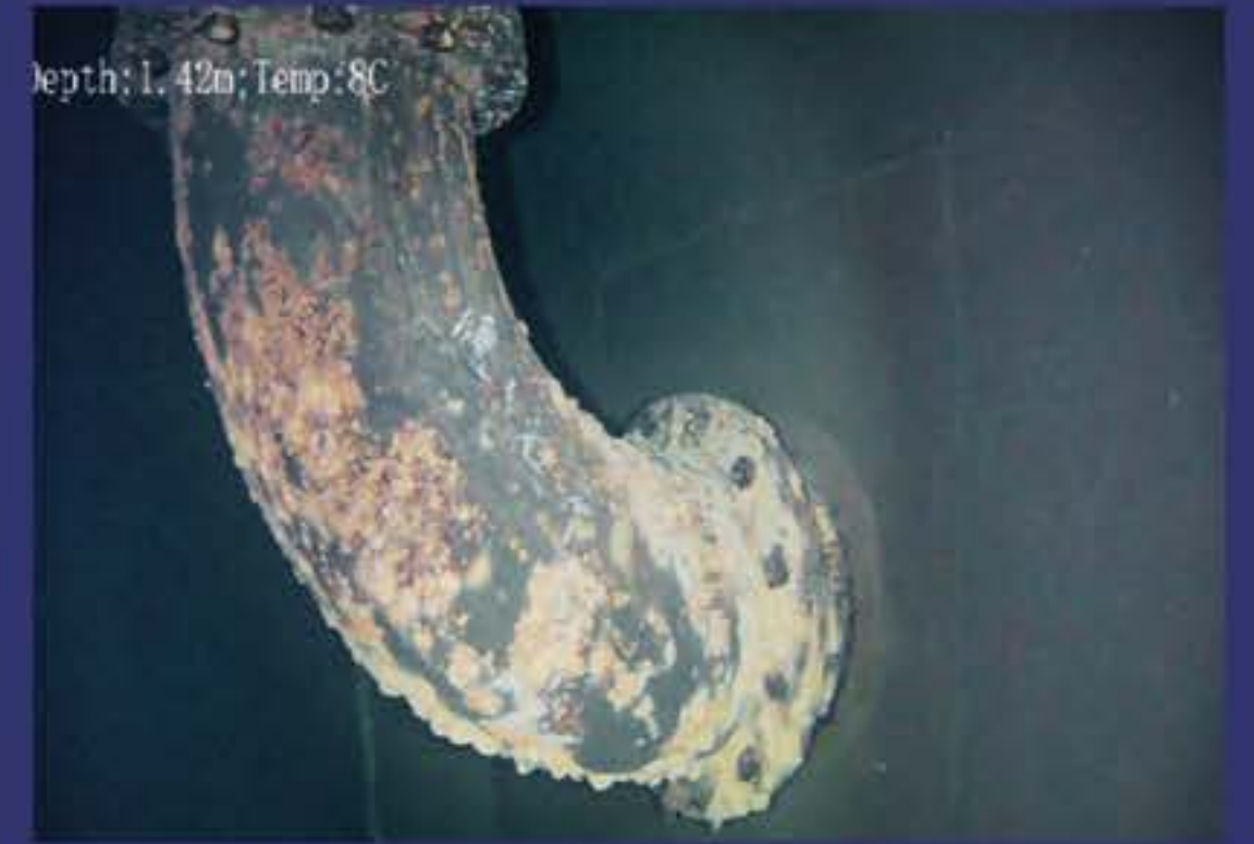
水中(配管)写真
